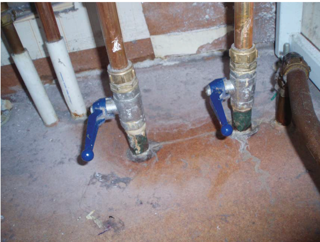
Kulventiler i stängt läge
